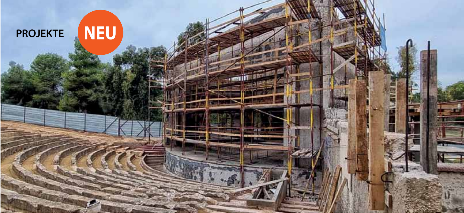
Das Mitte der 1950er-Jahre erbaute Amphitheater bedarf dringender Renovierung (Fotos: KKL-Fotoarchiv)
